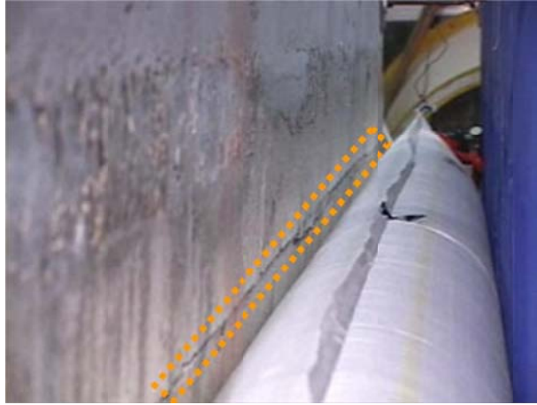
Figura 8. Grieta entre la sexta y séptima hilada de bloques
