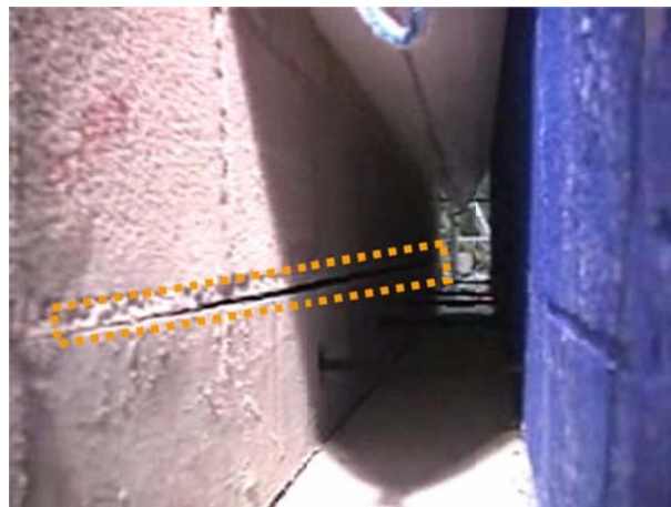
Figura 7. Grieta entre cadena inferior y primera hilada de bloques
