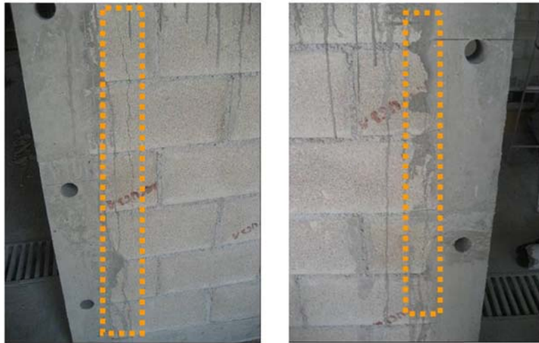
Figura 9. Grietas entre castillos y bloques
